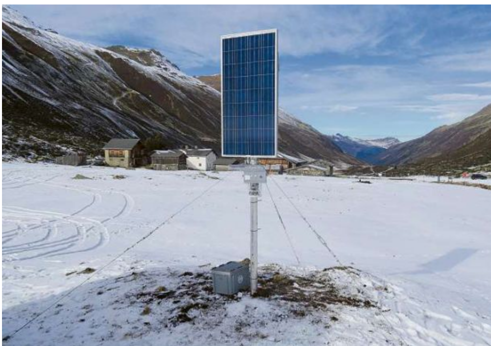
Rund um diesen Mast mit dem Solarpanel sind Infraschallsensoren und Seismometer vergraben. Sie erkennen auch Lawinenabgänge, die sich mehrere Kilometer entfernt ereignen.
